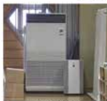
エアコン(室内機)
