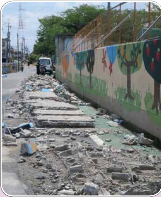
大阪府高槻市立寿栄小学校の崩壊したブロック塀
