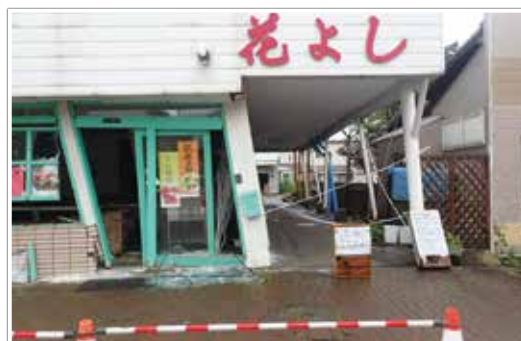
むかわ町被害状況
