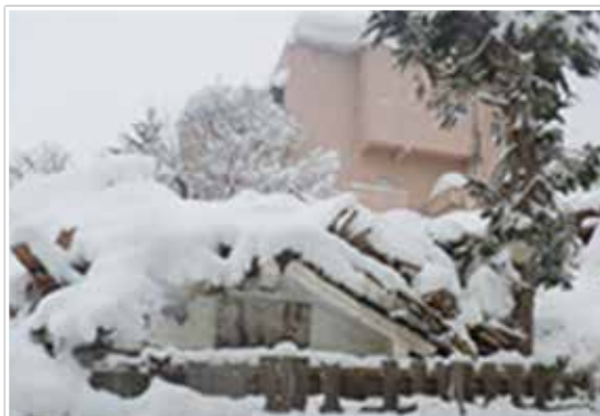
写真8 空き家の倒壊(平成27年(2015年)2月新潟県妙高市)
