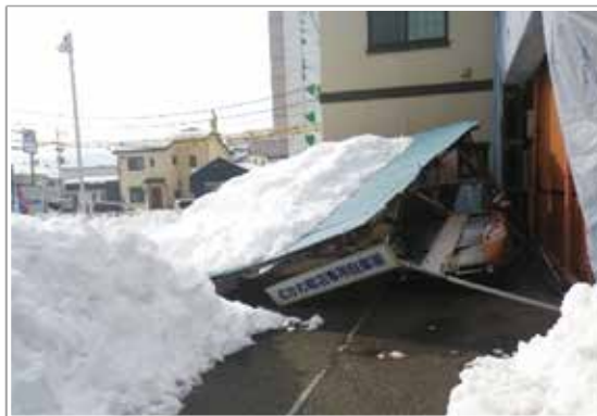
写真 1 大雪によって倒壊した簡易駐車場と車の被害 (山梨県甲府市)
