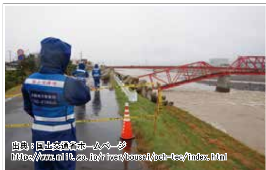
写真3 長野県上田市の落橋した鉄道橋
