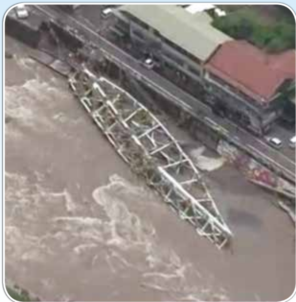
玖珠川の濁流で崩落した新天瀬橋 (大分県日田市天瀬町)
