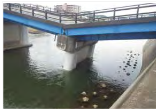
橋脚が沈下した黄瀬川大橋
