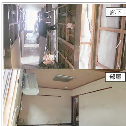
被災した宿泊施設 (応急補修前)
