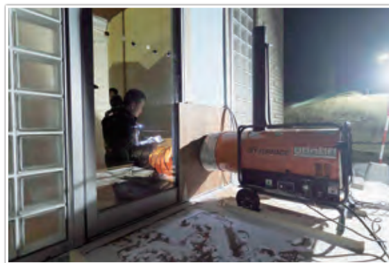
写真4 屋外に設置した熱交換式ダクトヒーター（燃焼CO 2 は外部へ、新鮮温風のみ室内へ）
