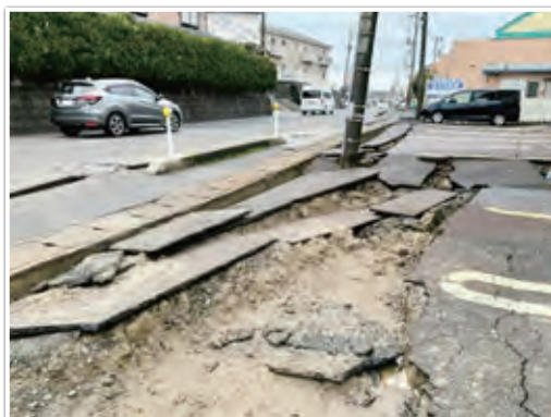
新潟県十日町市の被害状況
