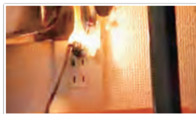
写真2 プラグからの出火イメージ（トラッキング現象）
