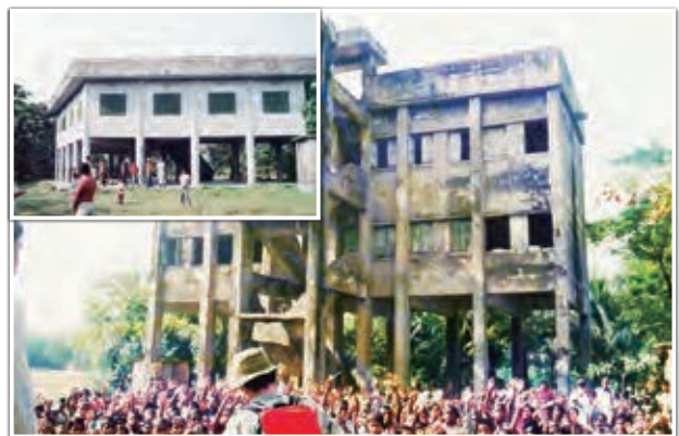
写真1 バングラデシュのサイクロンシェルター（1991年当時、小学校として利用されていた例が多い。コンクリートが劣悪なため、風化が激しい）。左上は最近のアロータイプのシェルター
